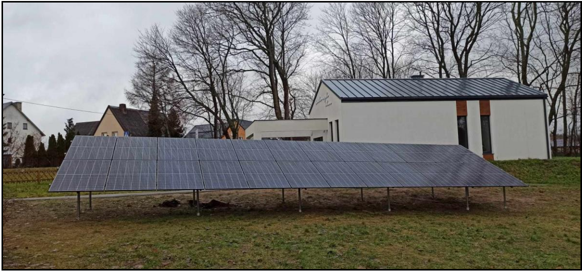
zdj. Instalacja fotowoltaiczna przy budynku świetlicy wiejskiej w Oskowie, źródło: www.cewice.pl
