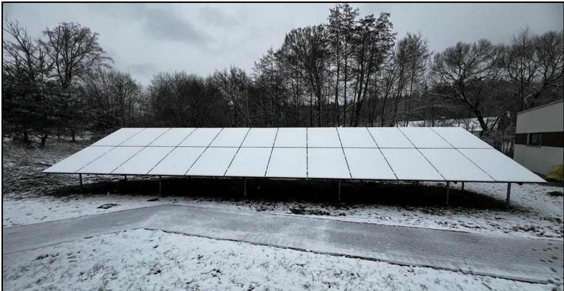
zdj. Instalacja fotowoltaiczna przy budynku świetlicy wiejskiej w Unieszynie, źródło: www.cewice.pl
