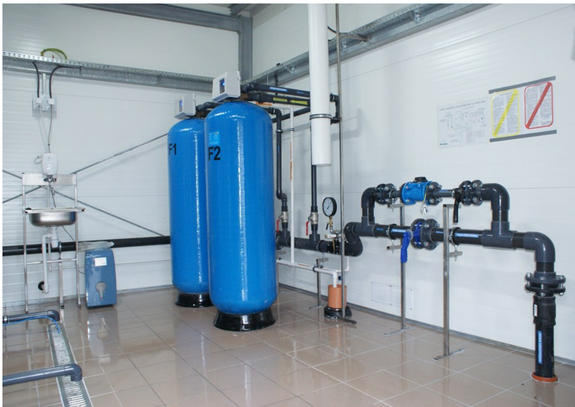
Stacja uzdatniania wody w Karwicy
