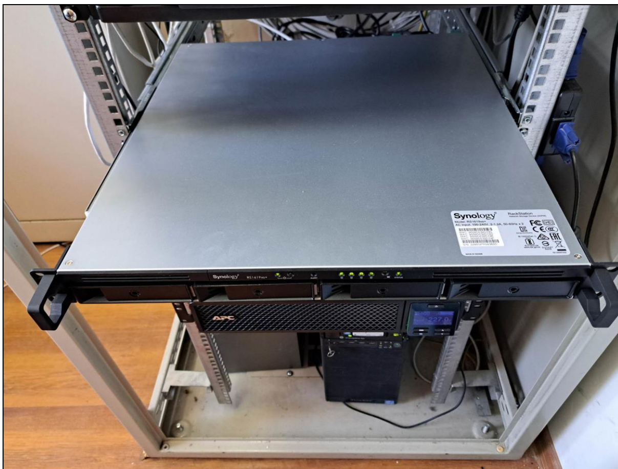
Fot. Serwer zakupiony w ramach realizacji projektu pn. „Cyfrowa Gmina”.
